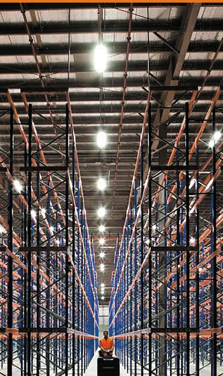
Освещение складских помещений
